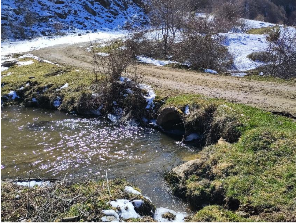
Φωτογραφία 4.2.34 Γενική άποψη οχετού. Θέα προς κατάντη (είσοδος ρέματος στον οχετό) (αρχείο ΕΠΠ, 2024).
