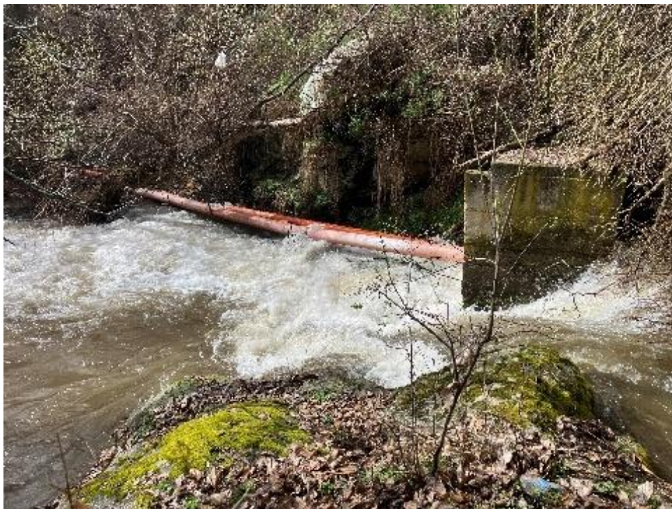
Φωτογραφία 4.2.20 Αναβαθμός πλευρικής υδροληψίας άρδευσης με λεκάνη ηρεμίας (θέα προς κατάντη) (Caudron & Vigier, 2025).
