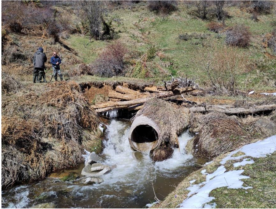
Φωτογραφία 4.2.37 Γενική άποψη διάβασης, στην οποία διακρίνονται οι ζημιές λόγω διαβρώσεων (Θέα προς ανάντη) (Caudron & Vigier, 2025).
