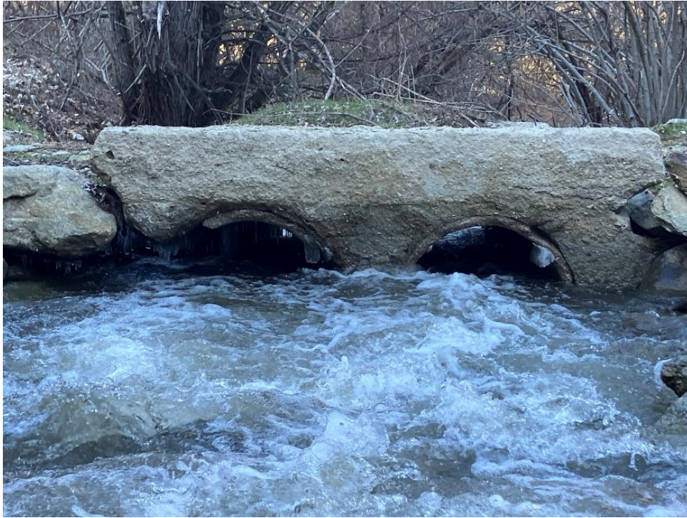
Φωτογραφία 4.2.30 Ανάντη όψη σωληνωτού οχετού. Διακρίνονται οι φθορές στο σκυρόδεμα εγκιβωτισμού των τσιμεντοσωλήνων (αρχείο ΕΠΠ, 2024).
